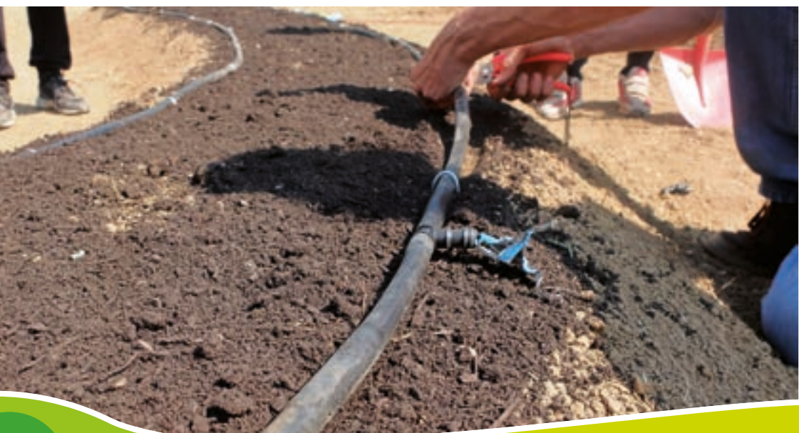
Un impianto di irrigazione a goccia
