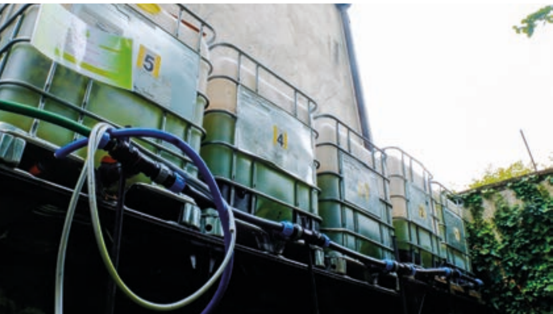
Cisterne di recupero dell'acqua piovana per l'irrigazione
