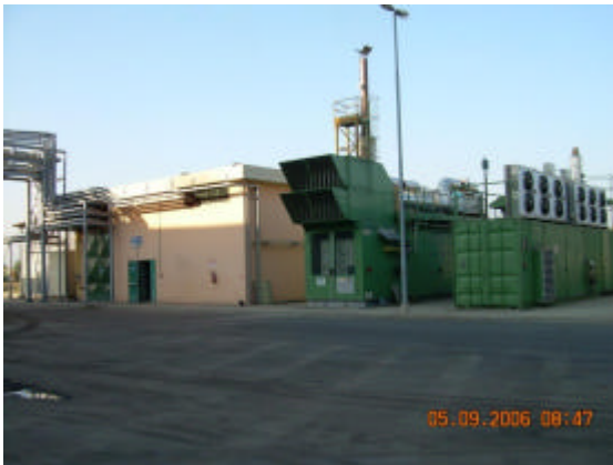
Impianto di Pinerolo (TO): due cogeneratori da 1100 e 950 kWe
