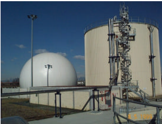
Impianto centralizzato di Camposampiero (PD): digestore da 3300 m 3 e gasometro
