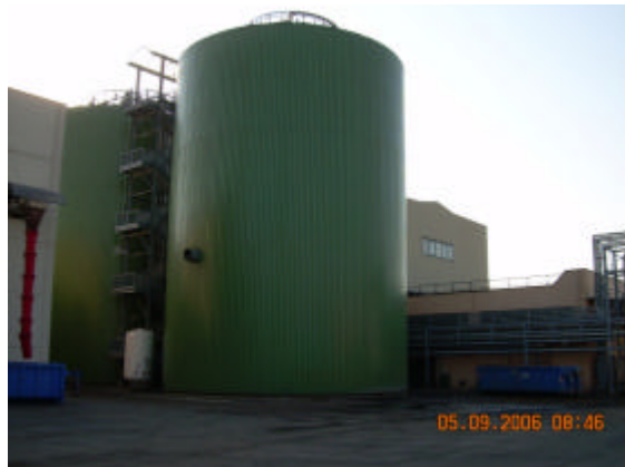
Impianto di Pinerolo (TO): due digestori da 2750 m 3 ciascuno
